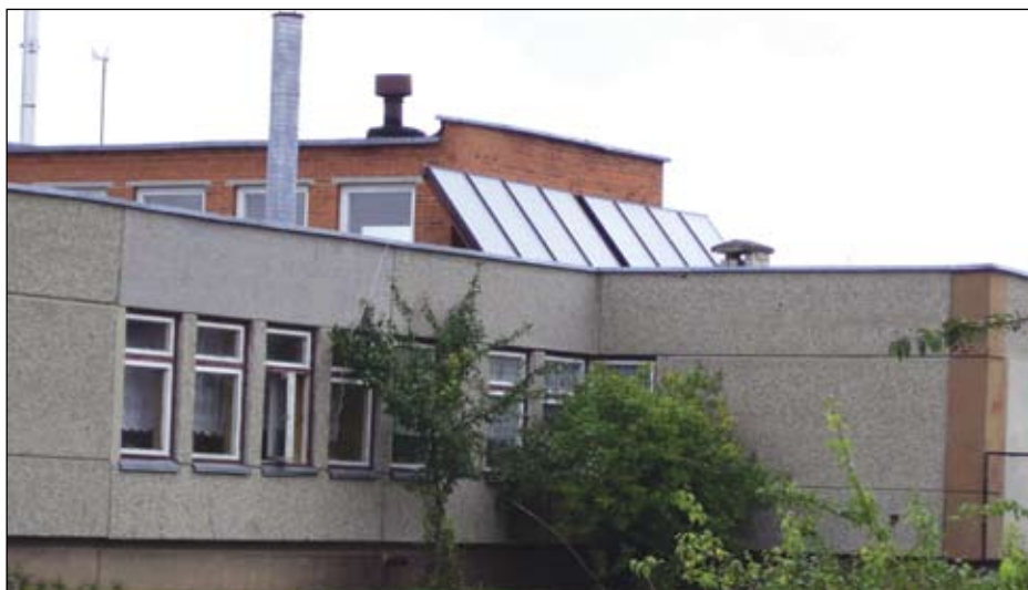
28 pav. Valgyklos saulės kolektorių baterija
