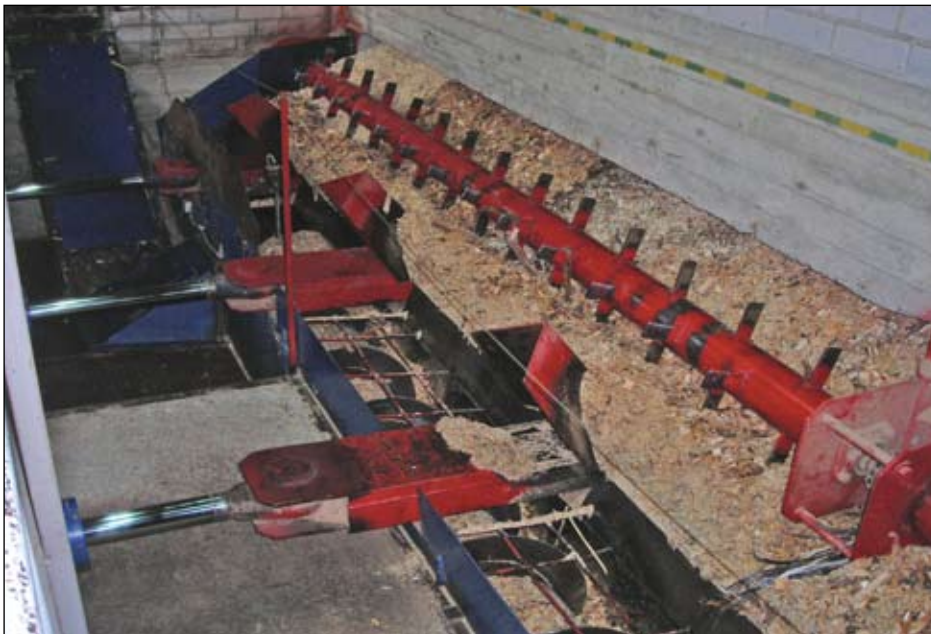
13 pav. Skiedrų tiekimo į pakurą mechanizmas
