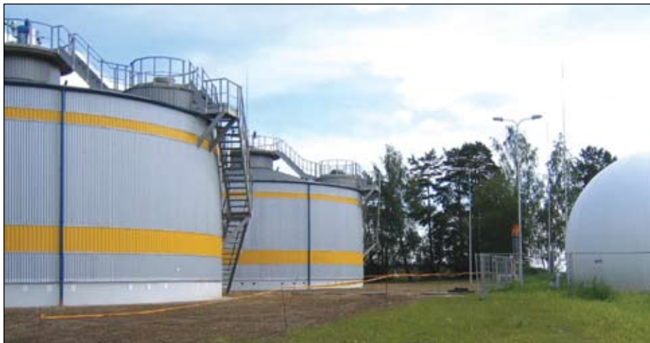
27 pav. Panevėžio vandenvals įmonės biodujų jėgainė
