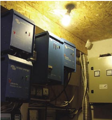
30.3 pav. Šalia laiptinės įrengta elektrinės valdymo bazė.
