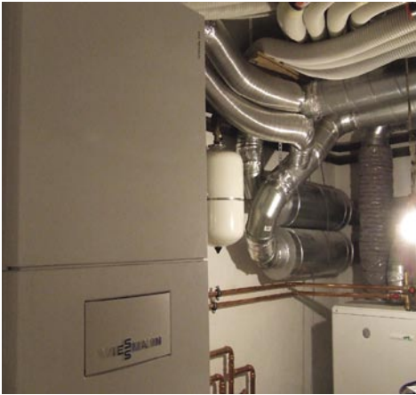
31.3 pav. Šilumos siurblys, rekuperatorius, vėdinimo sistemos vamzdynas.
