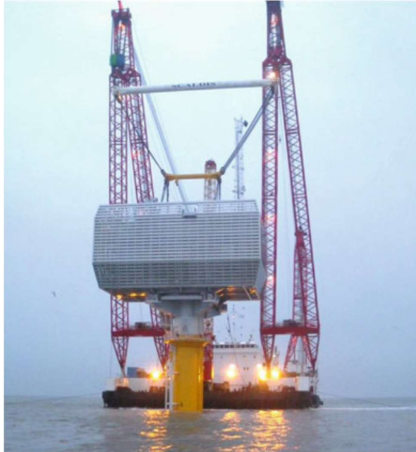
4.1.6 pav. Jūrinė elektros pastotė (šaltinis: Offshore Wind Power MarineServices).
