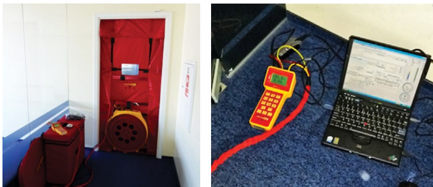
8.20 pav. Pagrindinė patalpos sandarumo testo metu naudojama įranga: pučiančios durys, duomenų apdorojimo prietaisai
